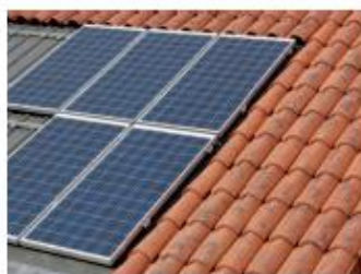
Fig. 3 Capteurs photovoltaïques en semi-intégration sur des éléments de substitution en acier (source : Soalis, Wagner – Inter-PV).
