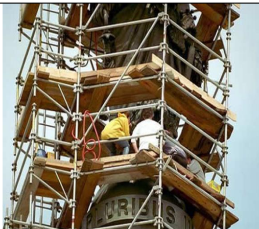
Fig. 5-8: exemple d'échafaudage fixe
