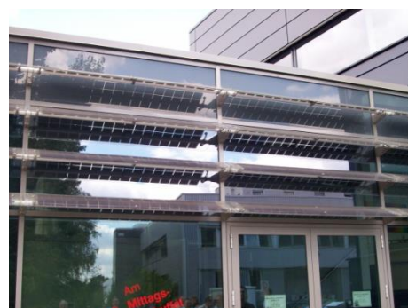
Fig. 3-42 : brises soleil société Solarwatt – Dresden (D)
