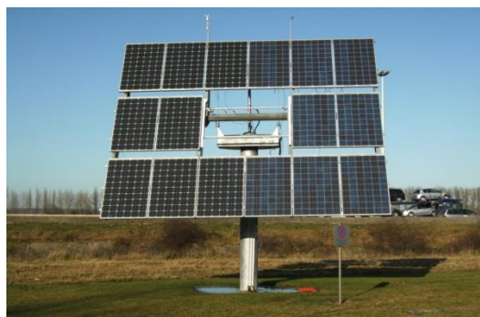
Fig. 3-47 : Suiveur solaire au centre FOREM Environnement
