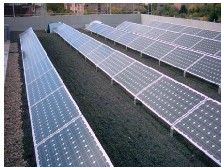
Fig. 3-33 : pose sur toiture – structure en aluminium
