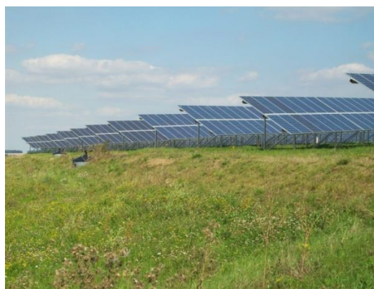
Fig. 3-46 : Installation photovoltaïque de la commune de Chemnitz (D)
