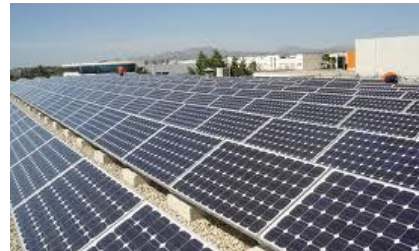
Fig. 2-4-1 : modules photovoltaïques monté sur plateforme
