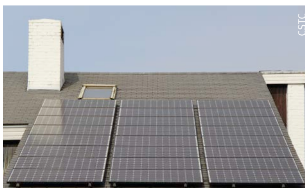
Fig. 3 Capteurs solaires photovoltaïques en surimposition.
