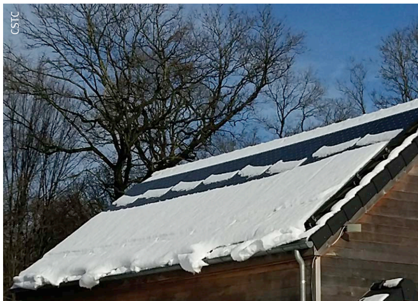
Fig. 11 Accumulation de neige au pied des capteurs solaires.
