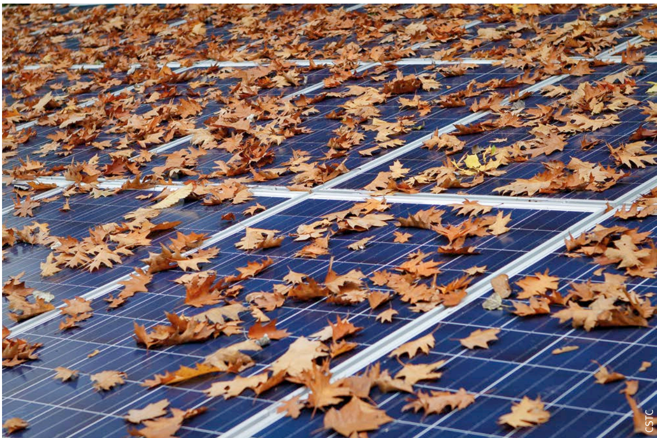
Fig. 54 Présence de feuilles mortes sur des capteurs solaires photovoltaïques.
