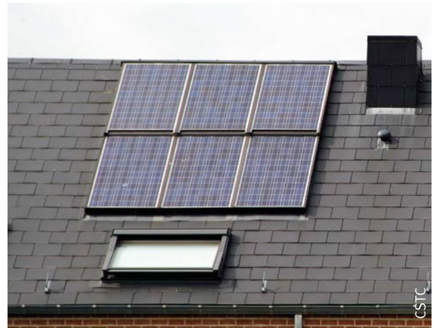
Fig. 6 Capteurs solaires photovoltaïques en intégration.
