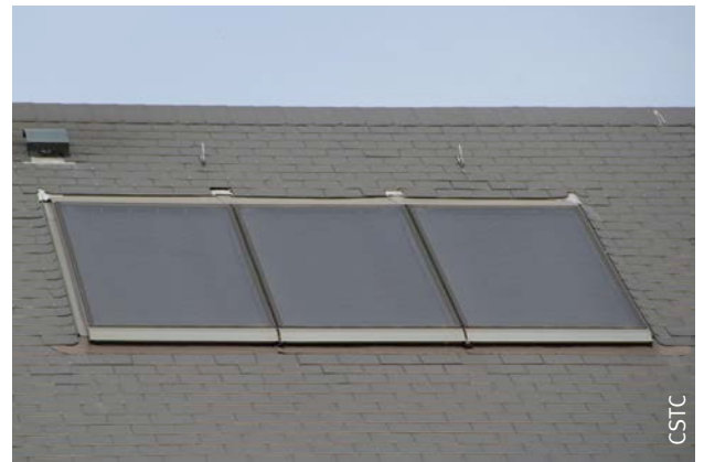
Fig. 7 Capteurs solaires thermiques en intégration.
