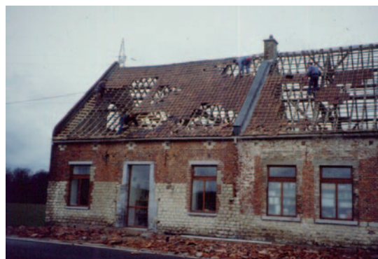
Fig. 51 Couverture arrachée par le vent.
