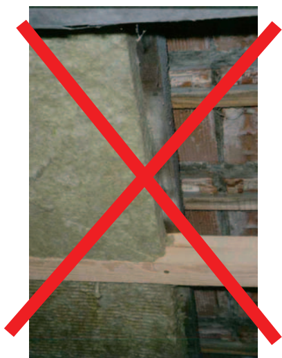
Fig. 56 Pose d'isolation sans sous-toiture : à éviter !
