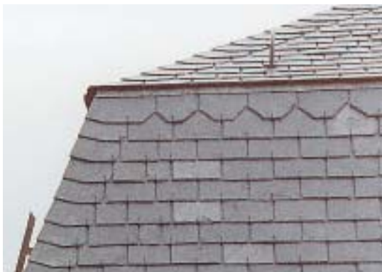
Fig. 48 Exemple de ligne de bris avec égout débordant et bande métallique.
