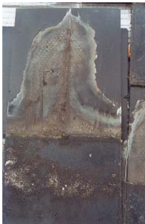
B. ZONE DE MOUILLAGE AVEC INFILTRATION À LA SUITE D'UN RECOUVREMENT INSUFFISANT
