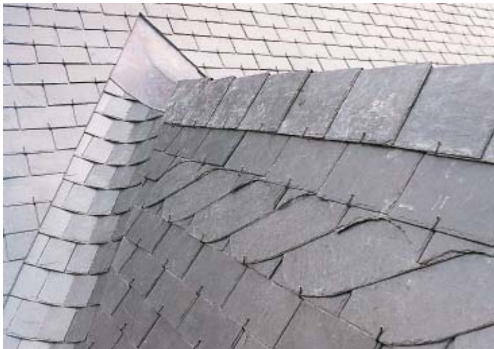
Fig. 79 Exemple de faîtage avec des ardoises en bardeli (et noue à deux tranchis).
