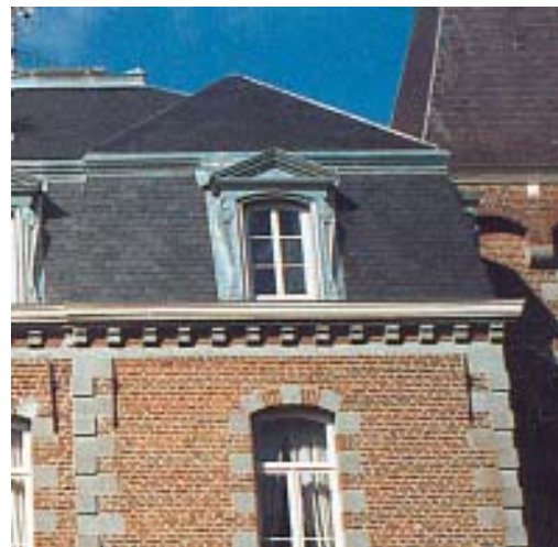
Fig. 49 Exemple de ligne de bris avec membron.
